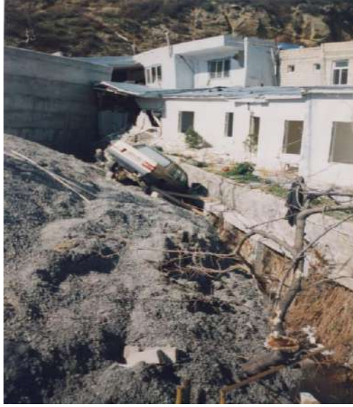
Şək. 1.10. 2000-ci ildə Bakı şəhərində Bayıl sürüşməsi, güclü zədələnmiş bina və qurğular
