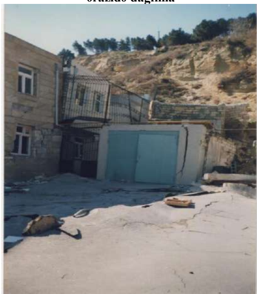
Şək. 1.9. 2000-ci ildə Bakı şəhərində Bayıl sürüşməsi, sürüşmə dilinin üzə çıxma zonasında deformasiya, səthdə və binada çatlar
