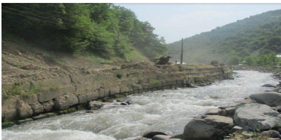
Şəkil 7. Tərtər çayı özül dəmir beton sahil mühafizə qurğusu
